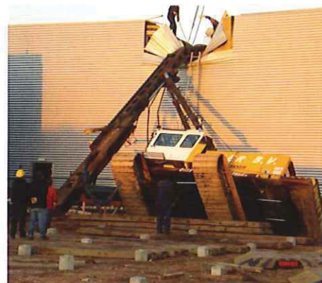
Het omvallen van kranen veroorzaakt grote schade en is levensbedreigend.
